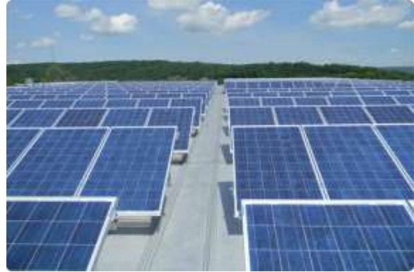
Solar PV Modules
